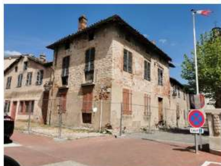
Exemple de bâtiments dégradés à Pont-de-Veyle
